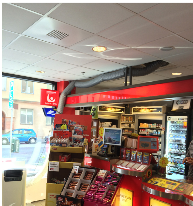
Impact installerad i Caroli köpcenter, Malmö
